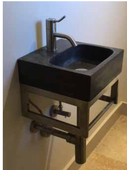
Handwaschbecken aus Bluestone mit Armatur Vola HV1
